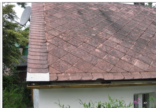
Fot. 2 Płyty azbestowo-cementowe płaskie
